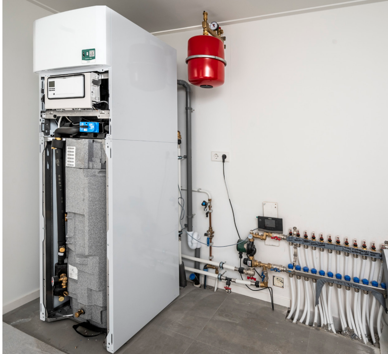
Het is belangrijk om te kijken of een geïntegreerde boiler in een warmtepomp gegarandeerd legionellaveilig tapwater aflevert.
