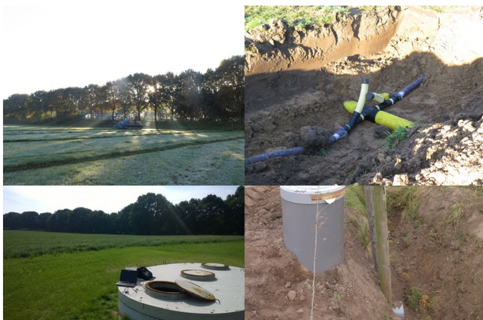
Figuur 3: Systeem voor sub-irrigatie op het perceel van Wilfried van Dijk. Linksboven: installatie van het drainage/infiltratiesysteem. Rechtsboven: ligging van de verzamelleiding (gele buis), de drainage/infiltratiebuizen, en de 'doorspuitstukken' voor eventueel onderhoud. Linksonder: wateraanvoerreservoir. Rechtsonder: eindput voor eventuele drainage van grondwater tijdens natte periodes.
